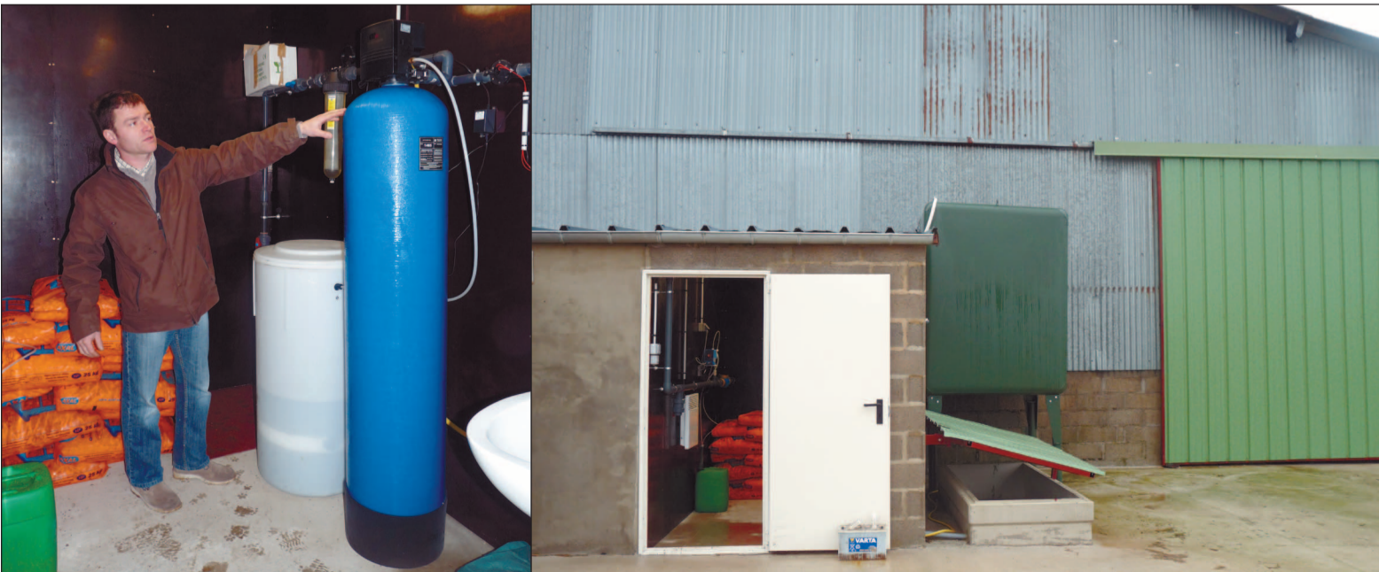
Branchée sur le réseau d'eau, la station Hydro-AFE® est installée dans un petit local à côté de l'aire de remplissage du pulvé ; à droite la cuve d'eau. Emmanuel Delahaye montre l'appareillage.
